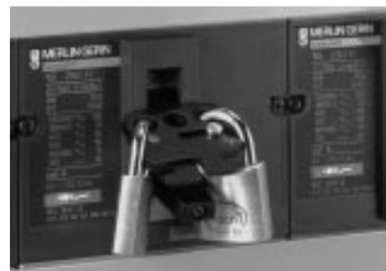
fig. 23 : dispositif de cadenassage sur un disjoncteur Compact (Merlin Gerin).
