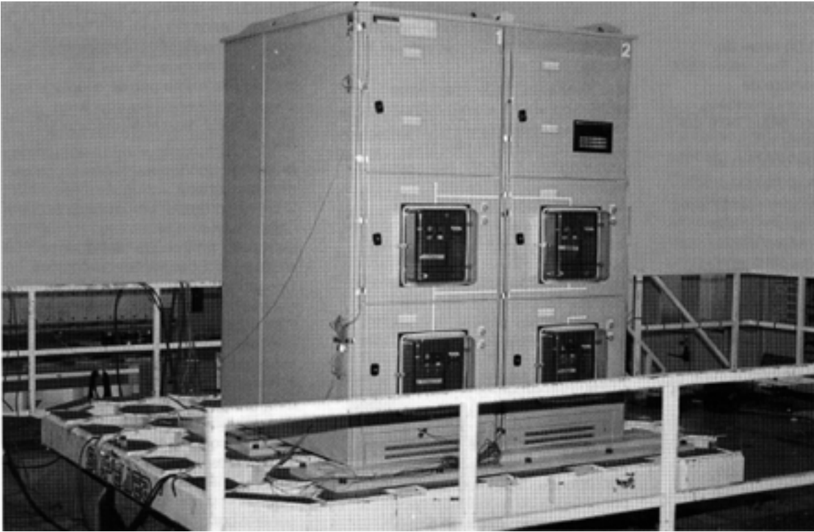
fig. 28 : armoire BT pour centrale nucléaire en cours d'essais de qualification.
