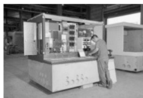
[b] poste MT/BT semi-enterré
