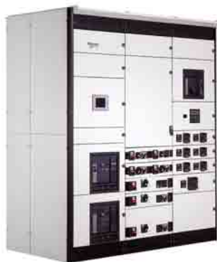
[b] TGBT et contrôle-commande de processus (Okken)
