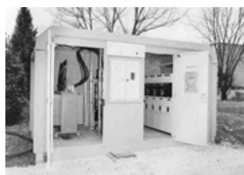
[a] poste d'intérieur MT/BT à couloir d'accès
